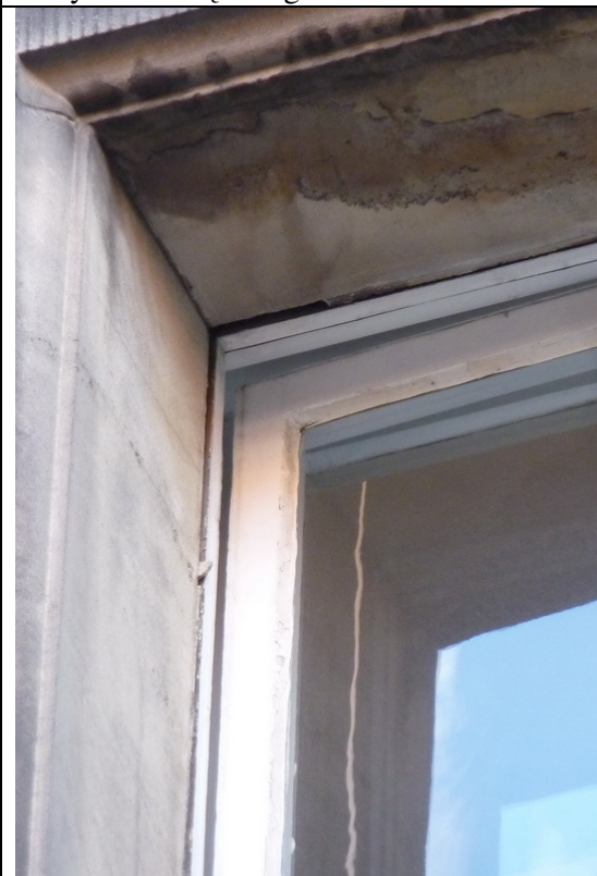
11. Niezamknięte skrzydło z powodu niesprawnego dawnego systemu zamykania.
