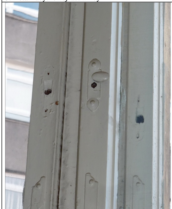
7. Sztydziki w górnych skrzydłach. Widoczne braki.
