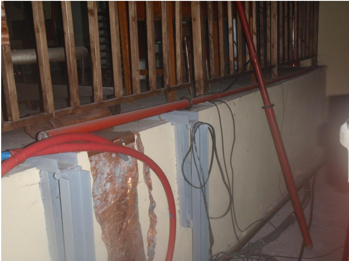
Rysunek 5. Widok ubytków tynku w WN 5 wraz z barierką
