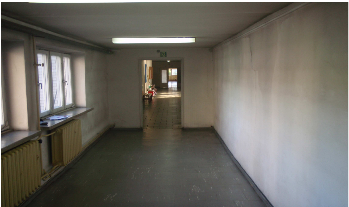
Rys. 7. Widok spękań łącznika- 2
