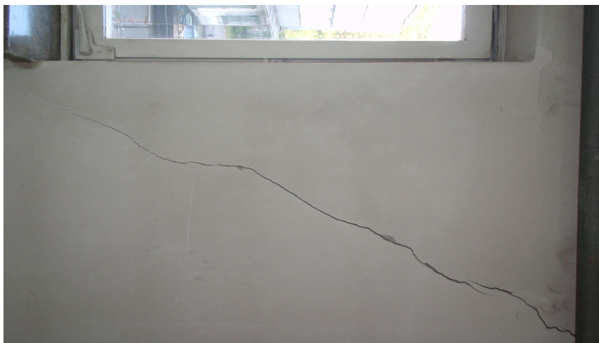
Rys. 9. Widok spękań łącznika- 4
