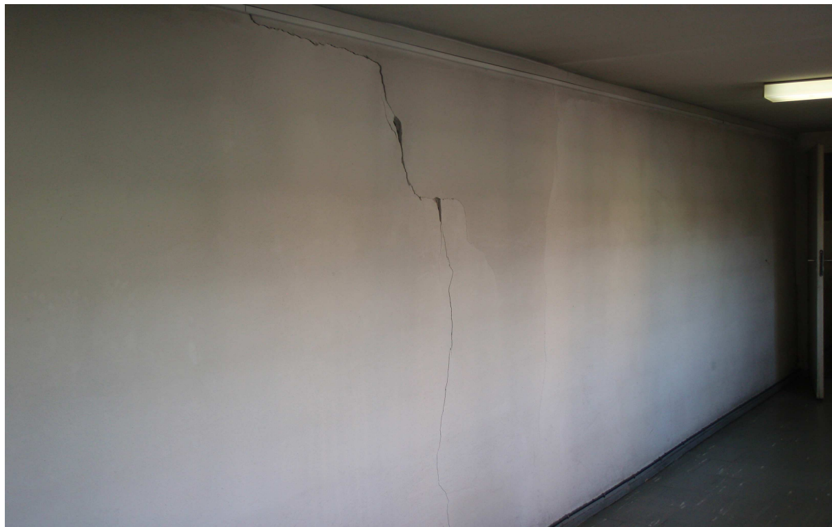
Rys. 8. Widok spękań łącznika- 3
