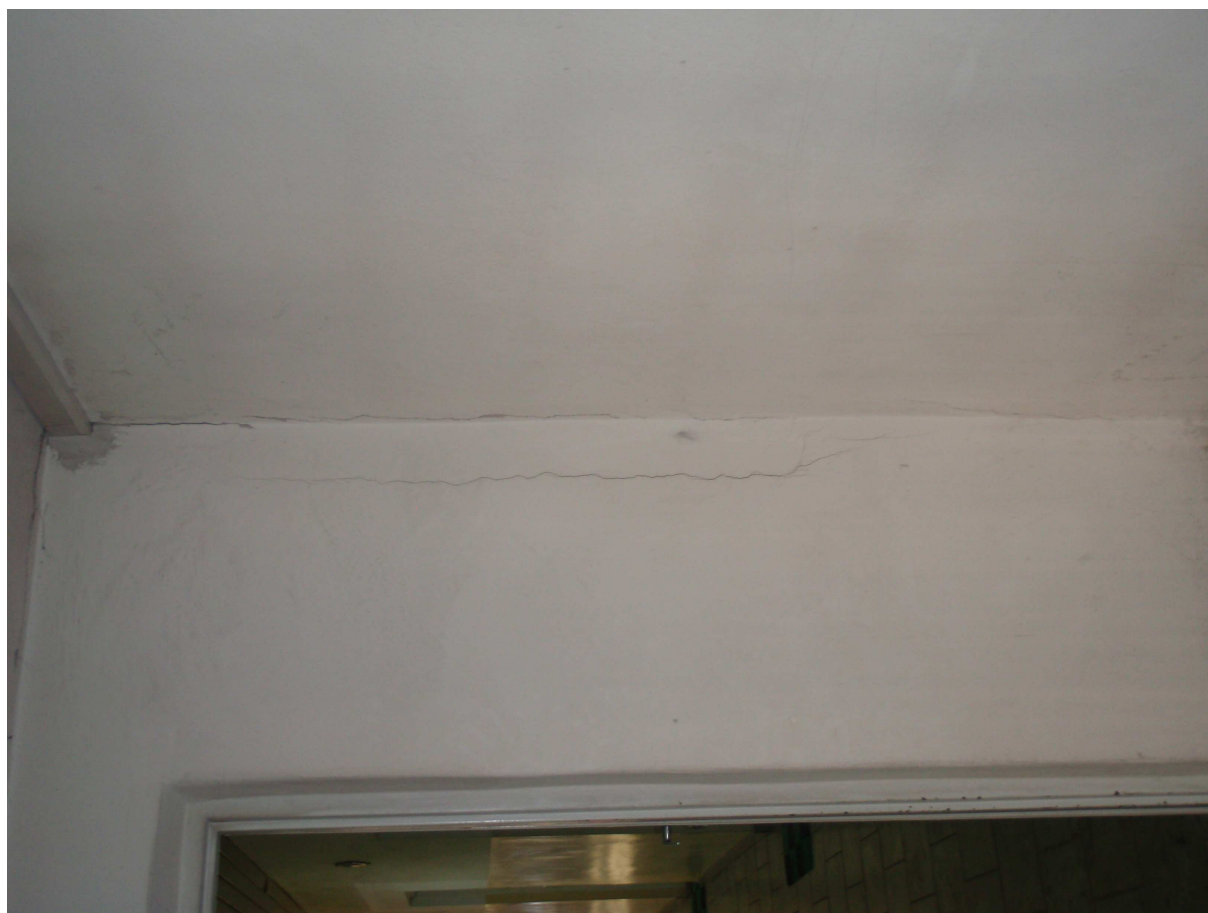
Rys. 10. Widok spękań łącznika- 5
