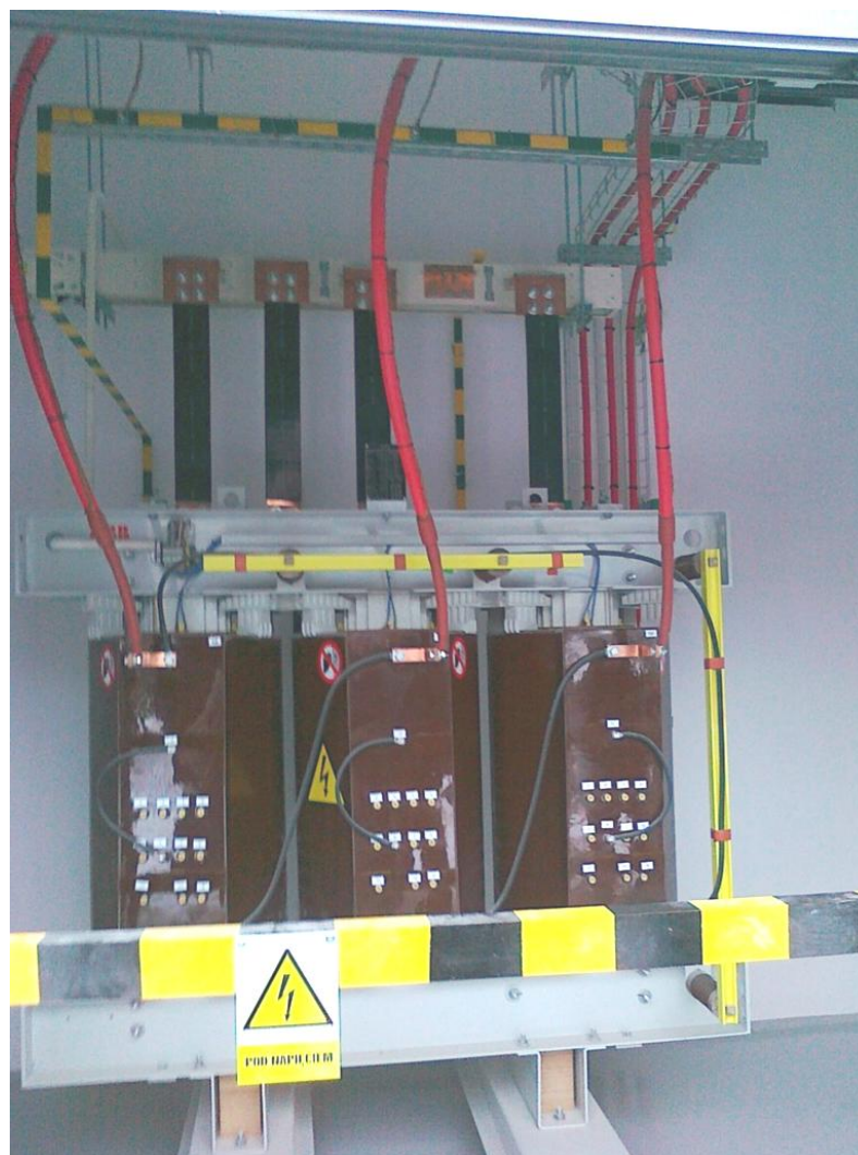
Rys. 2. Widok transformatora zainstalowanego w komorze transformatorowej stacji zasilającej Laboratorium LINTE 2
