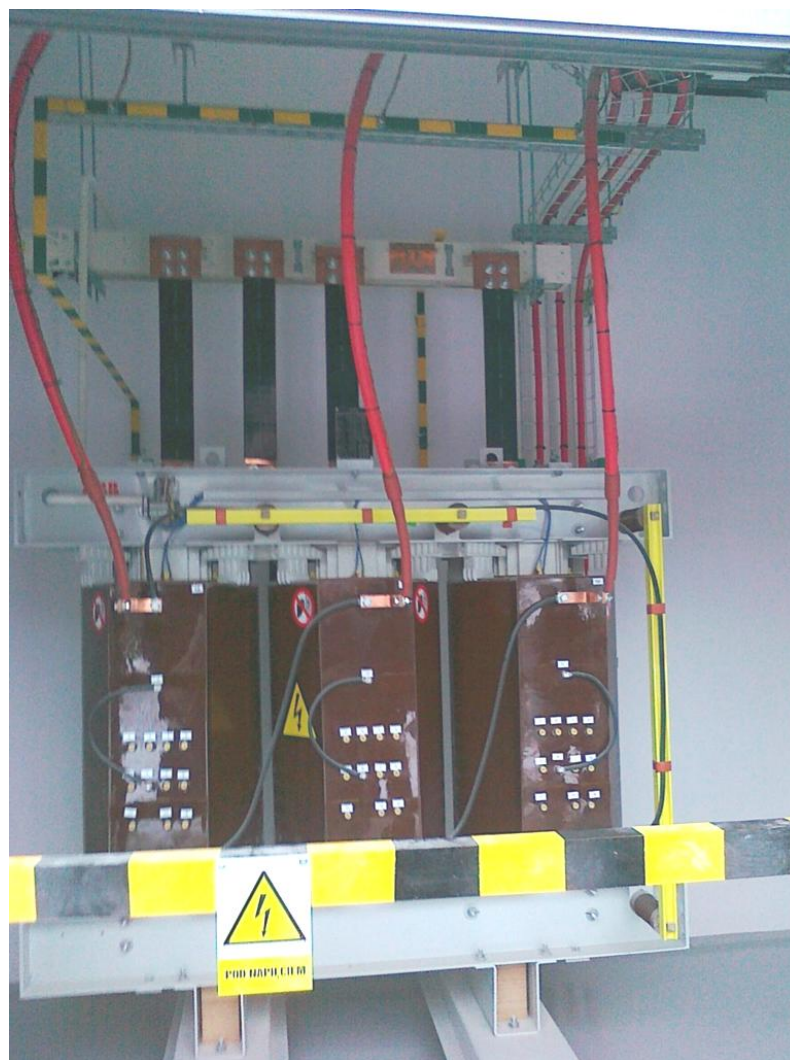
Rys. 6 Widok transformatora zainstalowanego w komorze transformatorowej
