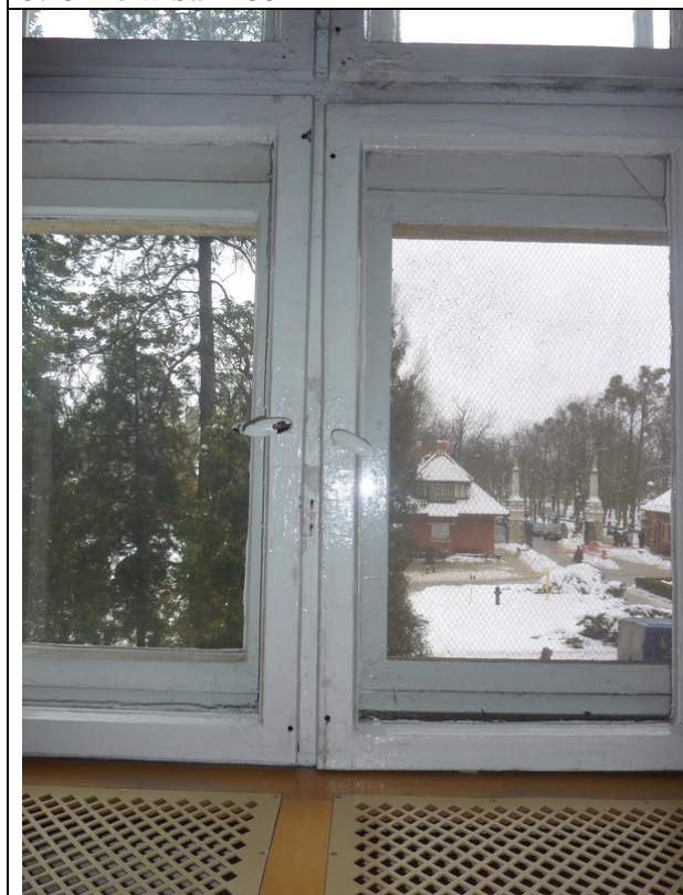
7. „Zwiśnięte” skrzydła zamknięte przy użyciu wkrętów
