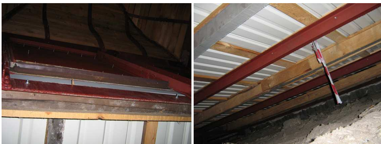
28. i 29. Zaślepienie blachą okno w latarni na elewacji oraz płatwie stalowe i drewniane
